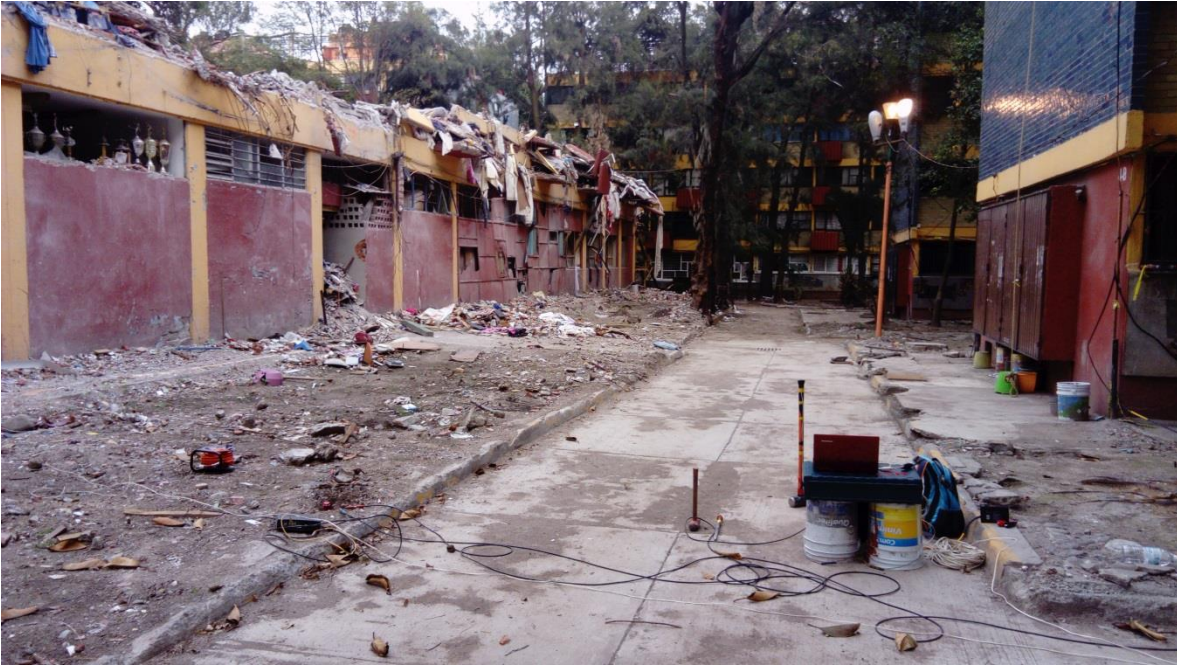
FOTOGRAFÍA 14. VISTA LATERAL Y EN DIRECCIÓN PERPENDICULAR A CALZ. DE TLALPAN, DONDE SE OBSERVA EL EDIFICIO COLAPSADO AL INTERIOR DEL CONJUNTO URBANO TLALPAN.
