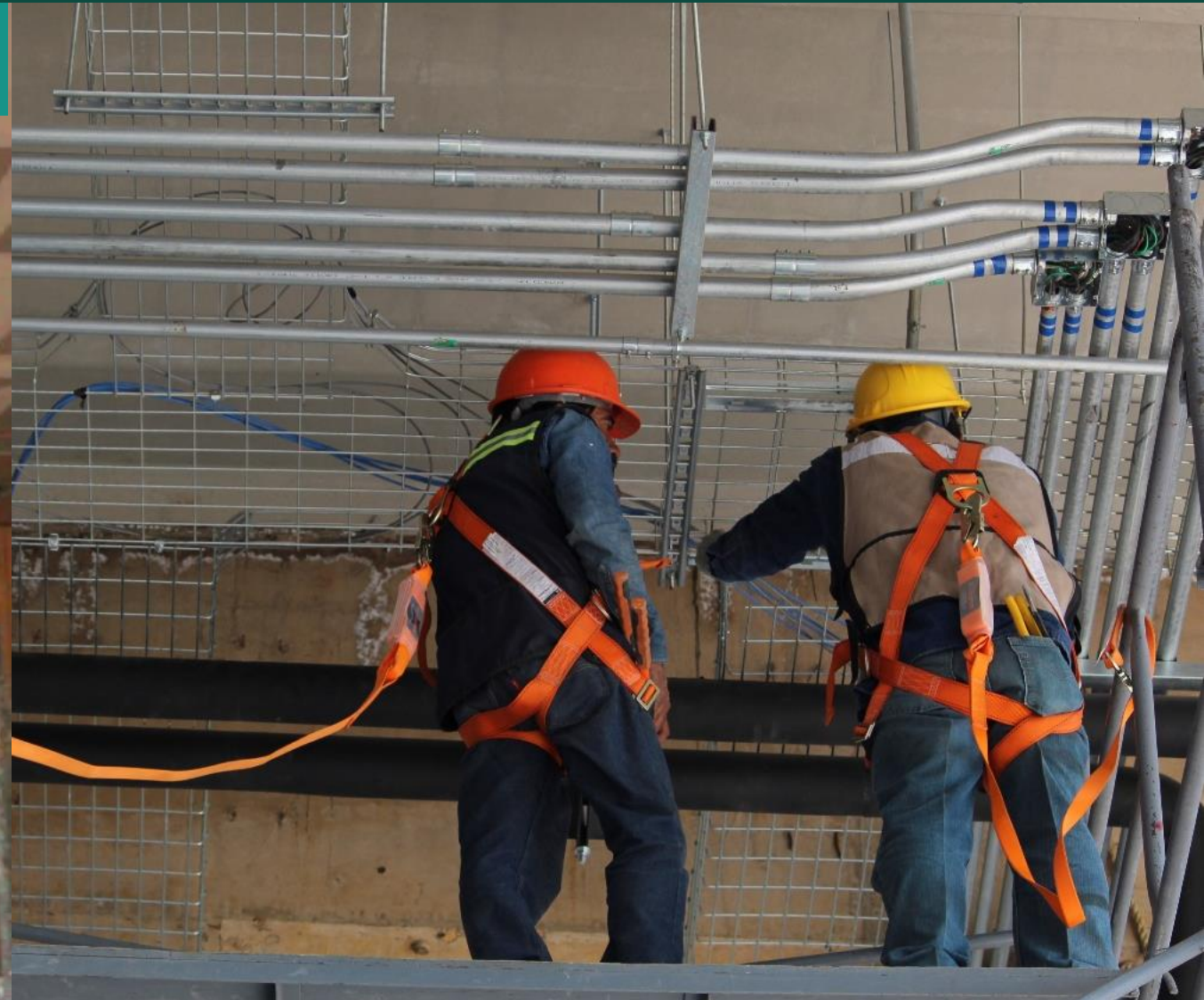
Instalación de UTP para servicios de voz y datos
