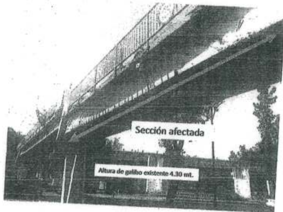
Imagen-2 Vista poniente del Claro Dañado.
